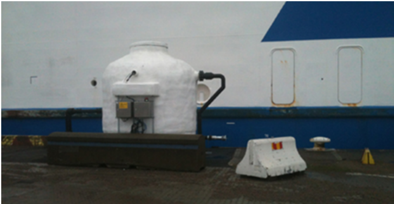
Figura 9: Recogida de aguas sucias en el puerto de Trelleborg (Suecia) (Fotografía: Clean Baltic Sea Shipping)
